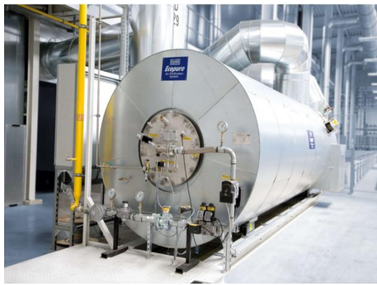
涂装车间-TAR 回用氧化炉
