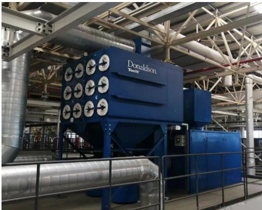
焊装车间-除尘器
